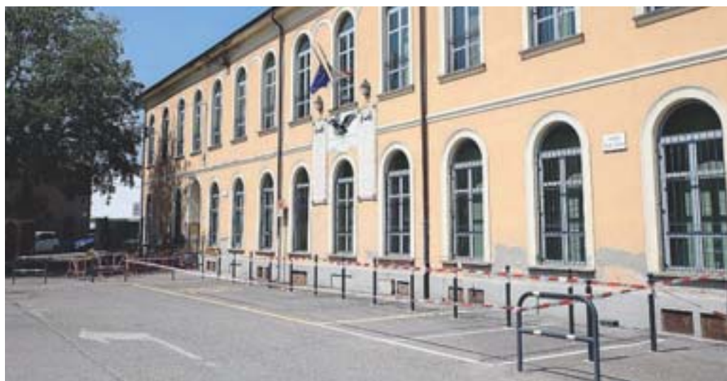
Il perimetro della 'Zanzi' messo in sicurezza a causa della caduta di intonaco
